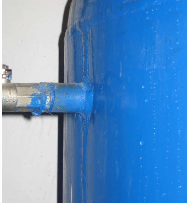
Şekil 1 : İlave yapılan manşon kaynağı boyuna dikişin üstüne yapılmıştır.
