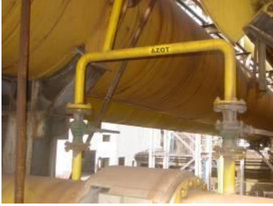
Resim 11 Gaz boru hatları ve azot gazı verme noktası
