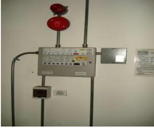
Resim 5 Yangın algılama sistemi ekipmanları:
