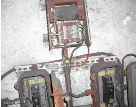
Resim 1a Uygun olmayan elektrik anahtarları
