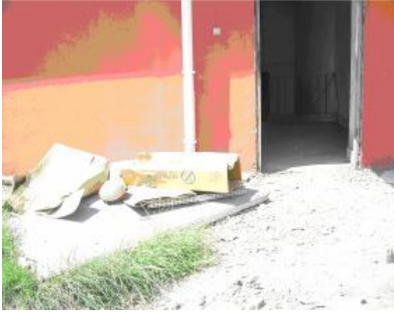
Resim 3a Kablo tüneli giriş kapısı yok
