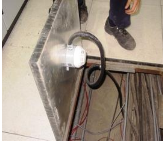
Resim 8 Yükseltilmiş döşeme altında bulunan duman
