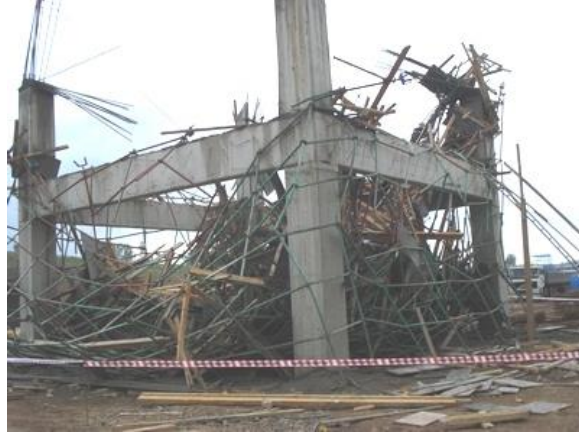
Örnek 3; Tabliye betonunu taşıyan iskele sisteminin emniyetsiz kurulumu neticesinde meydana gelen çökme olayı.
