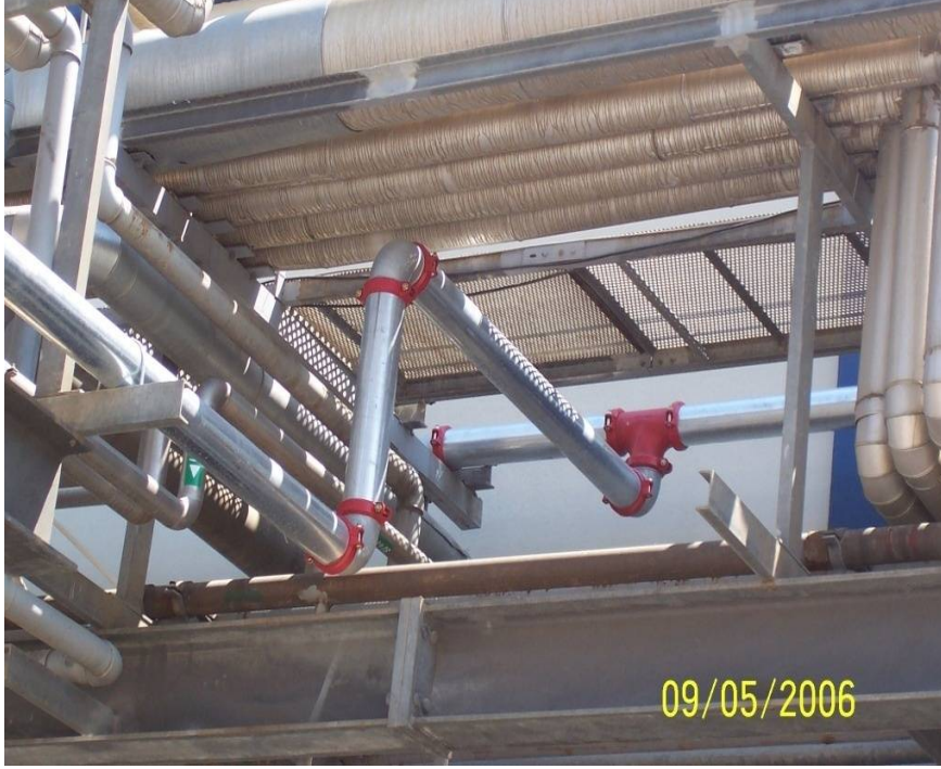
Fotoğraf 9 – Yangın Su Tesisatının Yivli Bağlantı Şekilleri
