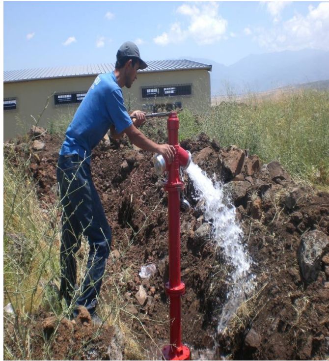
Fotoğraf 13 –Yangın Su Hidrant Tesisatından Hava Alınması
