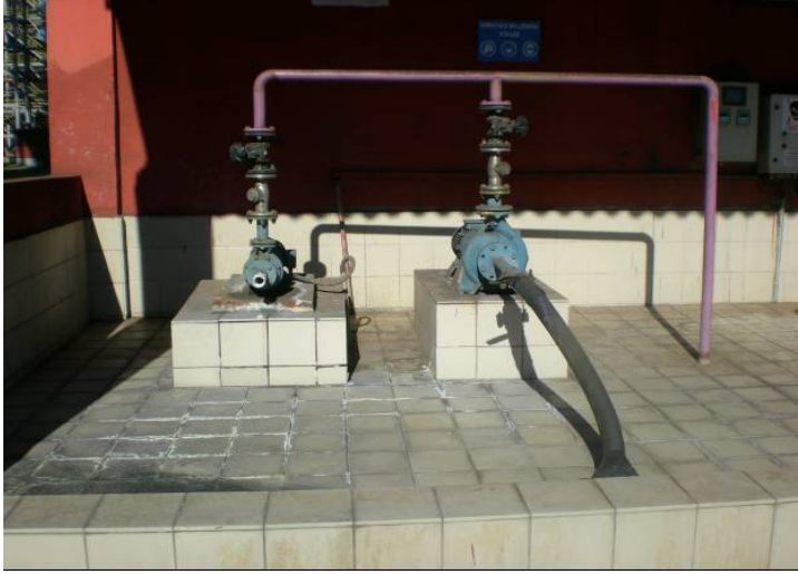
Fotoğraf-5 Asit tankları dolum istasyonu ve nötralize havuzu
