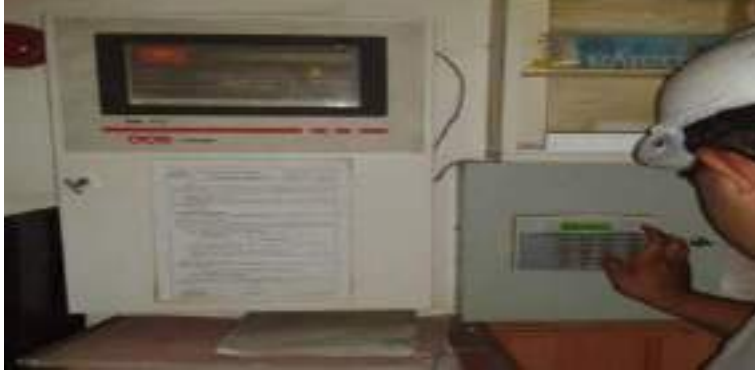
Resim-1: Yangın Algılama Sistemi Paneli
