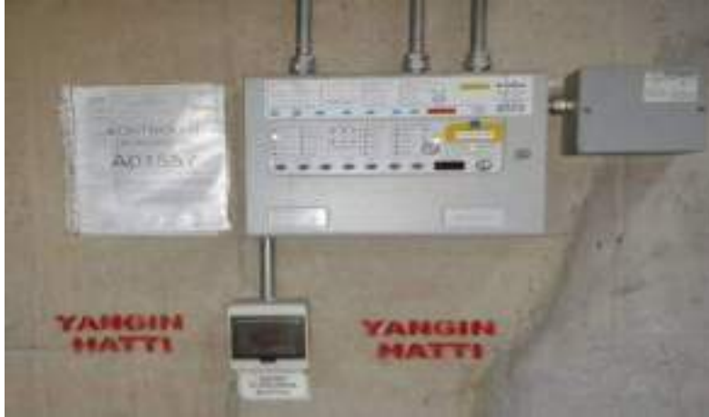
Resim-2: Yangın Söndürme Sistemi Paneli
